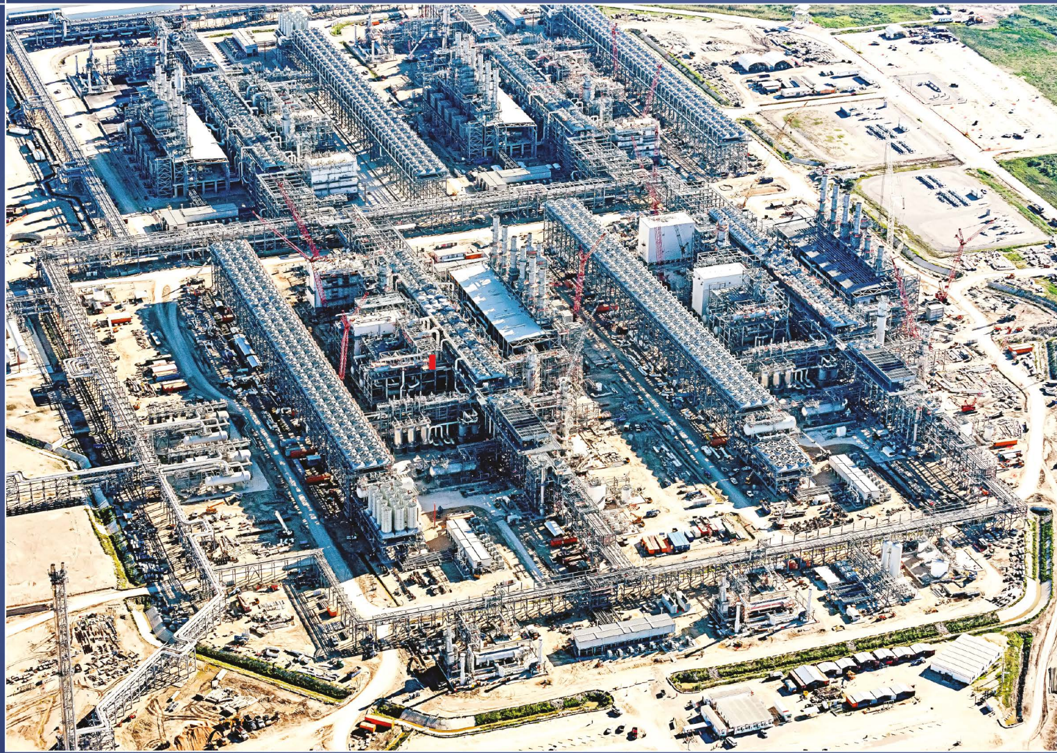
SABINE PASS LNG 6 TRAINS
